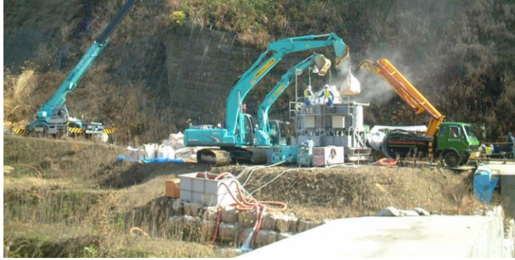
プラント基地の設備
