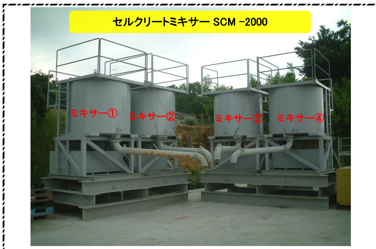
定置式プラント（2組設置）
