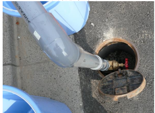
吐出管設置状況
