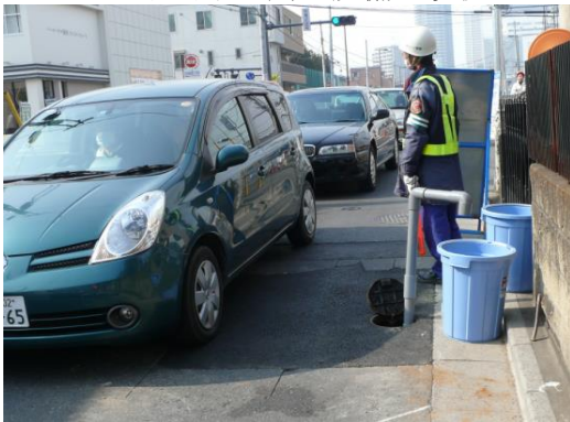
到達側 吐出口設備の状況
