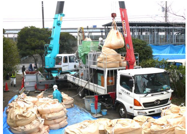
吐出口設備 排水用ホース及び予備注入管
