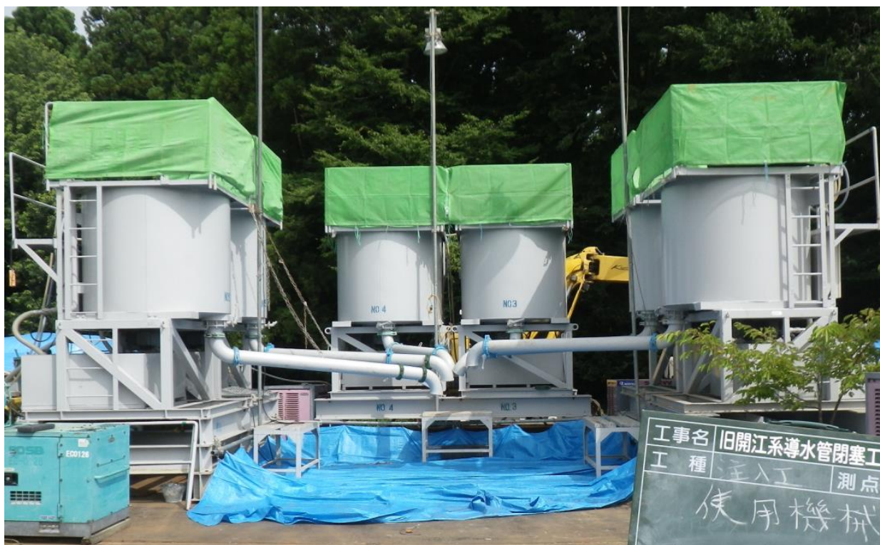
設置状況（3組集合設置） 一日当り 1組 100m 3 /日 × 3組 = 300m 3 /日 の充填が可能
